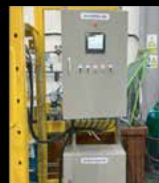
ローカルコントロールユニット/ ソレノイドバルブボックス
